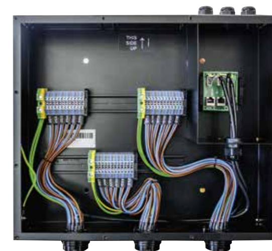
L'interno dei box LKS Data pre-cablati con morsettiere per le connessioni di potenza e RJ45 per le connessioni dati.
