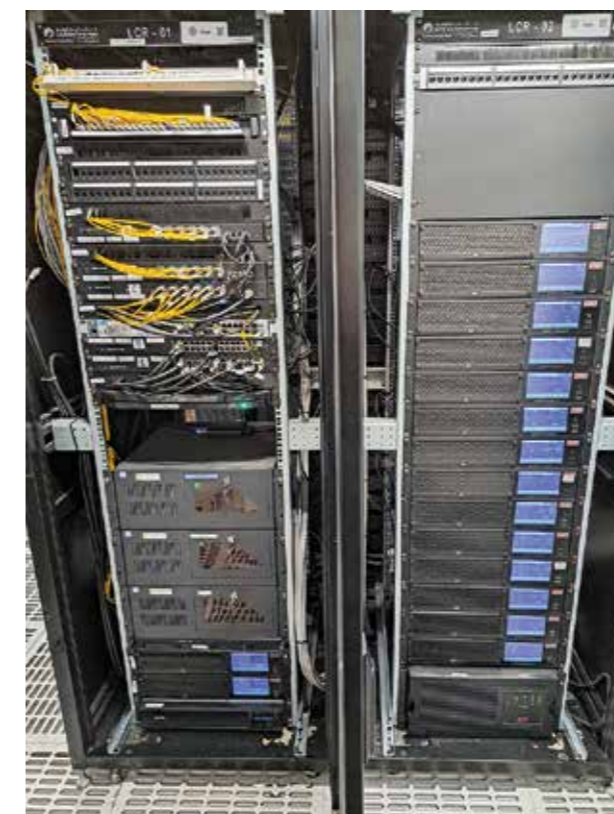
Uno dei Network Rack, contenente i GMA3 PU-M.
