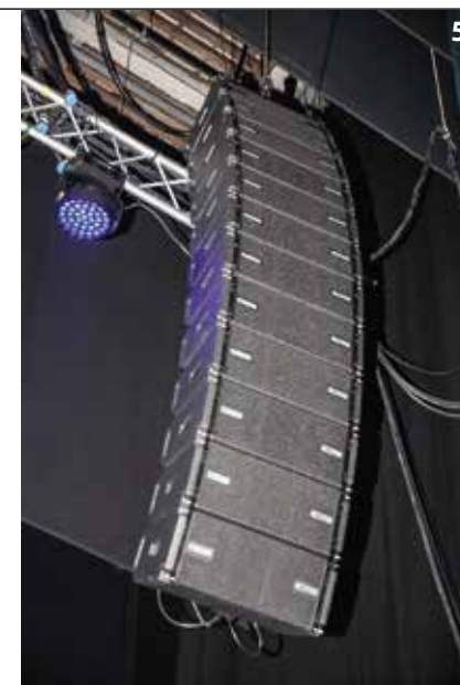
5_ Un lato dell'impianto main, un array composto di 12 dB Technologies Vio L208.
